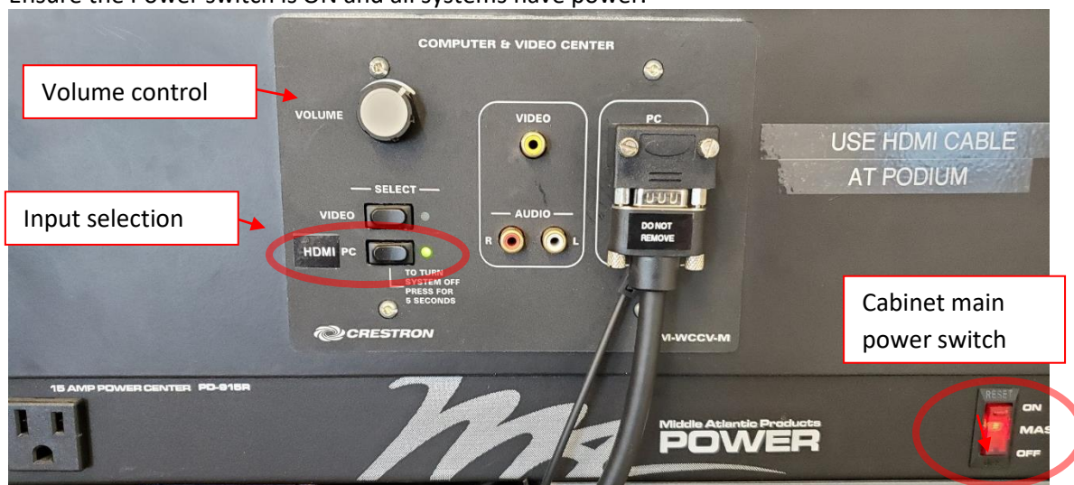
Figure 1: ETB 535 AV cabinet control panel
